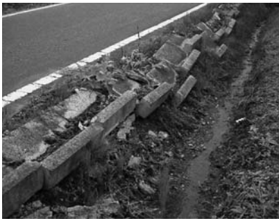
大雨で被害を受けた道路
