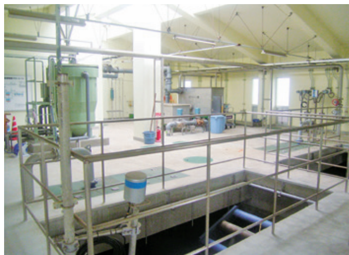
集落排水処理施設
