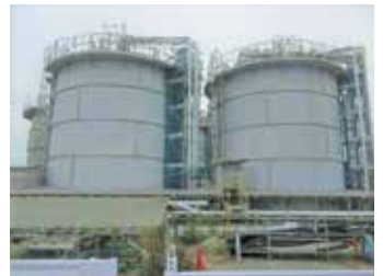
処理水を貯留するフランジ型タンク
